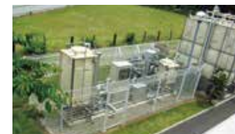
地下水膜ろ過システム
